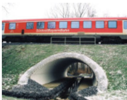
Bild 5: Durchlassbauwerk mit beidseitigem Laufsteg für Amphibien, Kleintiere, u.ä.
